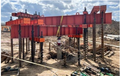
Установка с нагрузкой до 200 тонн
